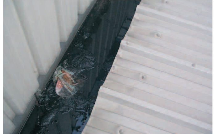
Acumulación de suciedad en un canal.
