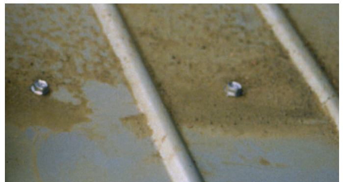
Moho sobre un revestimiento de acero prelacado.
