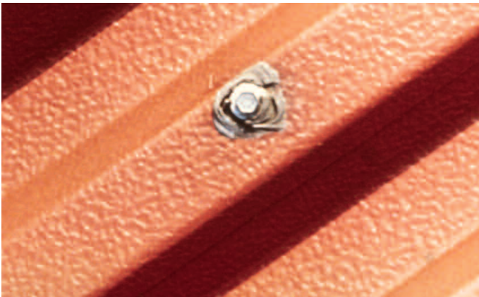
Anclaje dañado sobre el revestimiento de una cubierta.
