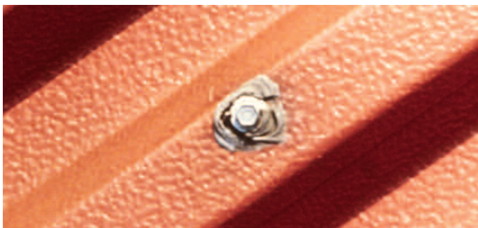
Поврежденный крепежный элемент кровли.
