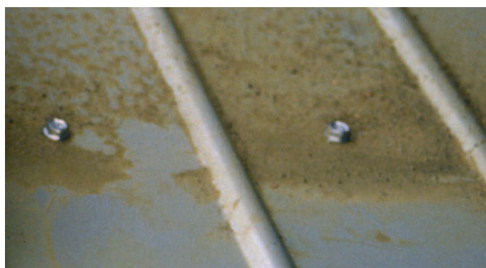
Плесень на поверхности облицовки из стали с покрытием.
