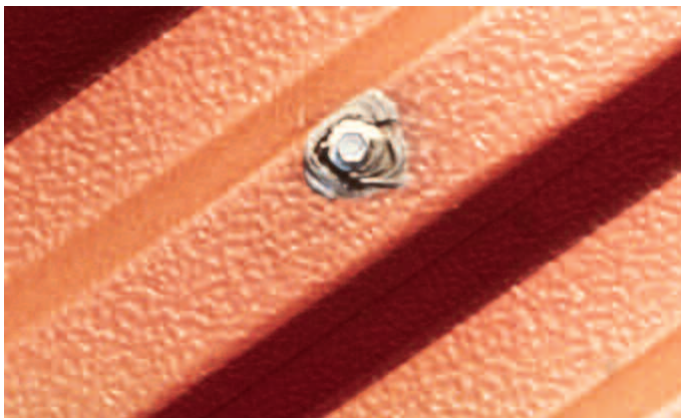
Uszkodzony wkręt na pokryciu dachowym.
