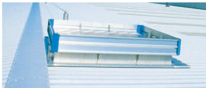
Otwór w pokryciu dachowym.
